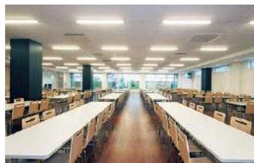
LED照明（食堂）
